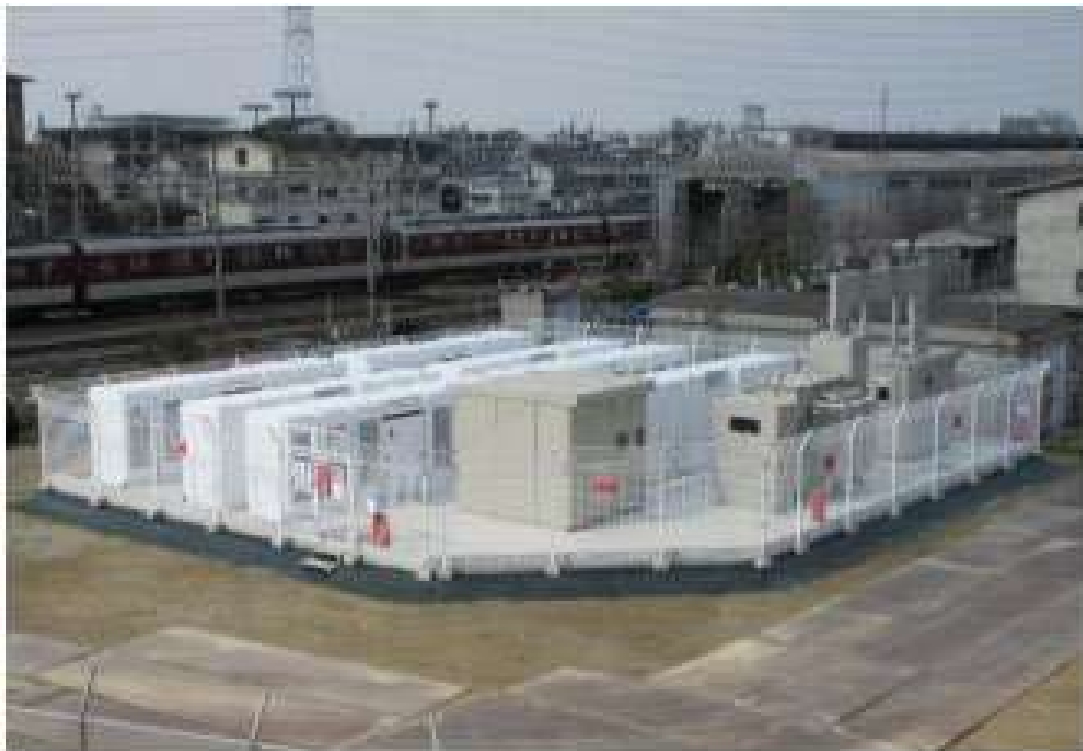
大容量蓄電池システム（近鉄プレスリリースから）
