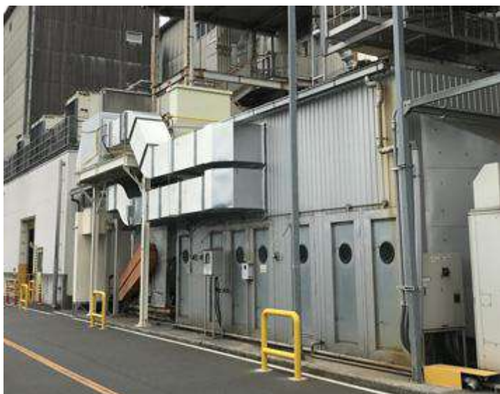
図 4 熱利用サイト(放熱サイト)外観(日野自動車羽村工場内の産業空調設備)
