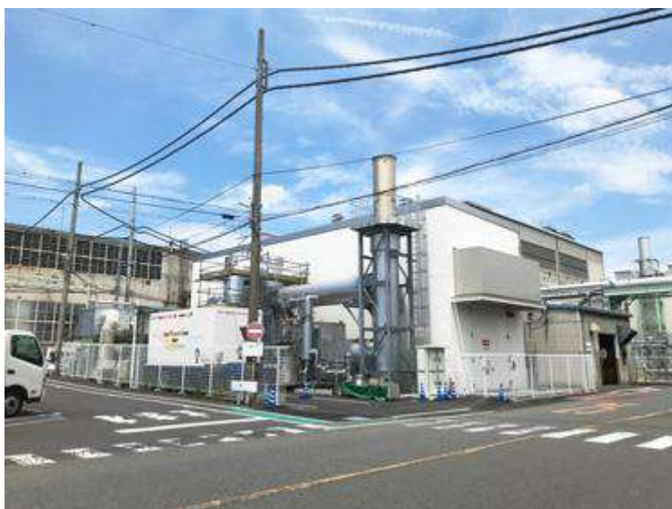
図 3 蓄熱サイト外観（日野自動車羽村工場内の CGS）
