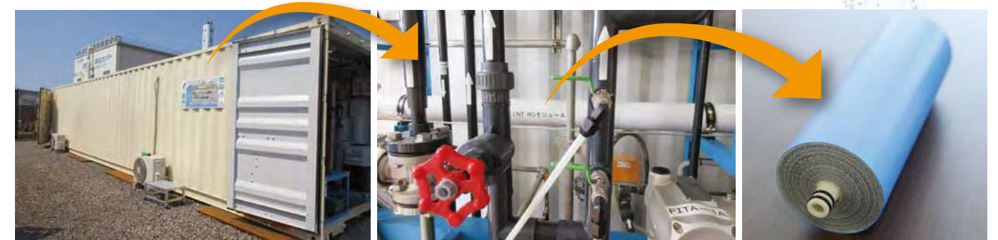
■図6 海水淡水化のパイロットプラント。長さ約12メートルのコンテナ内に、ナノカーボン複合RO膜モジュールを搭載した海水淡水化装置、膜の耐久性などを評価するための薬品ユニット、水槽などを設置している。最初に汚れを取り除いた後、海水に高い圧力をかけ、膜モジュールに通して塩分を取り除く。
